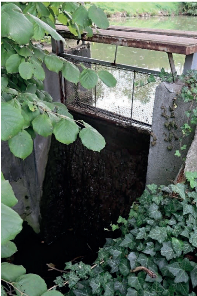
Obr. 3. Pěniová tabule na přelivu hráze protipožární nádrže v Korozlukách u Mostu. Foto V. Joza.
